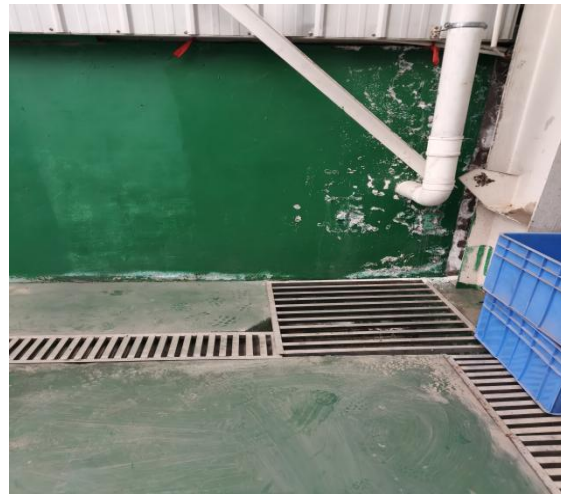
导流槽、集液池
